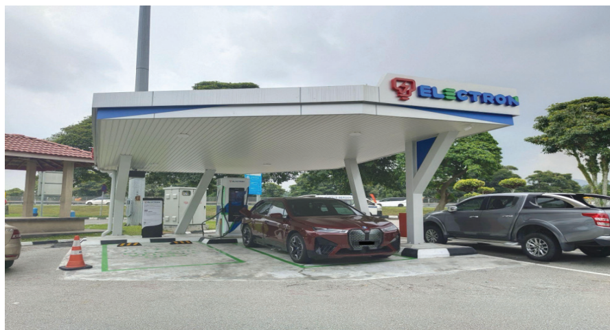
Gambar 2: Stesen EVCS di Kawasan Rehat & Rawat Tapah (Arah Utara), Lebuhraya Utara Selatan
